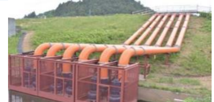
仮設の排水ポンプ (給食センター裏)
